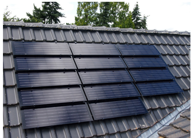
Kleines SOLo-System auf dem Dach
